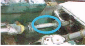
磁氣式活水器安裝狀況
